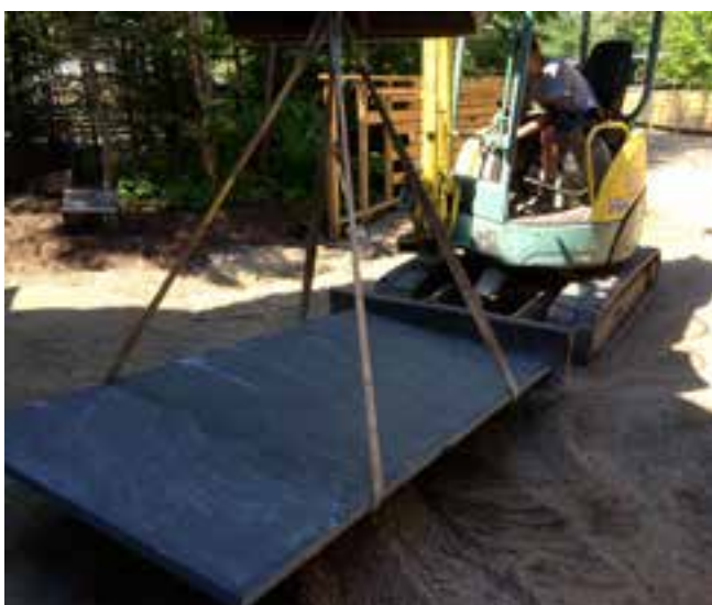
Délicate manutention d'une gigantesque dalle d'ardoise de près de 900 livres avant son installation sur une fondation granulaire compactée.
